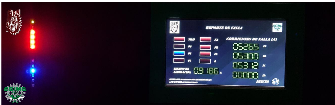
Figura 5. 18. Panel frontal del reporte de falla del relevador para una falla trifásica en el bus C del esquema de prueba.
