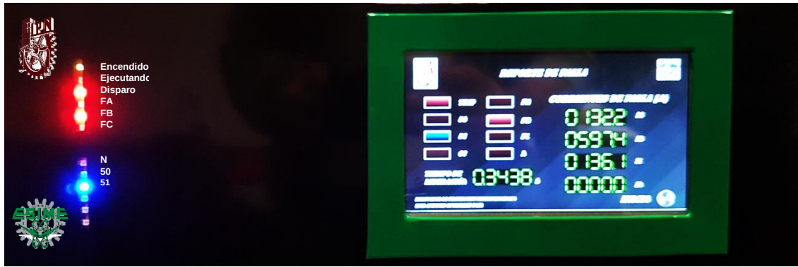
Figura 5. 12. Panel frontal en condiciones de falla de 10 A RMS en la fase “B”.
