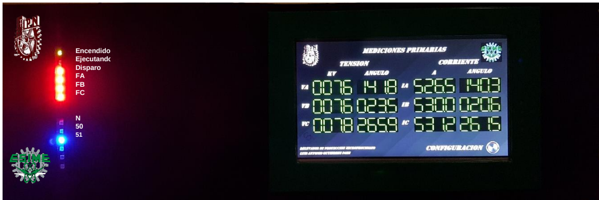
Figura 5. 16. Panel frontal de mediciones del relevador ante una falla trifásica en el Bus C del esquema de prueba.
